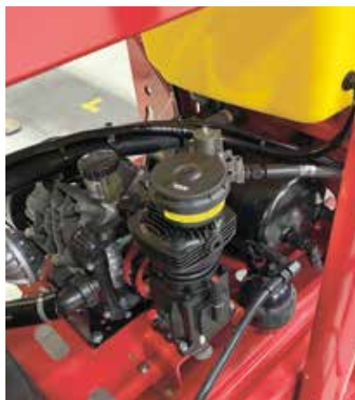
Compressor na pomp + luchtketel met overdrukbeveiliging
